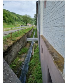
Beispiel: Gefahr für das angrenzende Gebäude durch den künstlich errichteten Graben.
