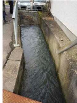
Beispiel: Mögliches Problem durch das verstopfte Gitter bei der Ansammlung von Ästen und Laub.
